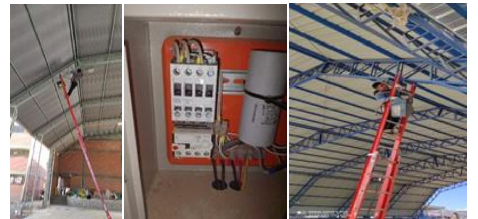
FOTO 4 Mantenimiento de Redes Eléctricas y Cambio de Focos, Enchufes, Interruptores, Instalación de Enchufes salas de Computación).
